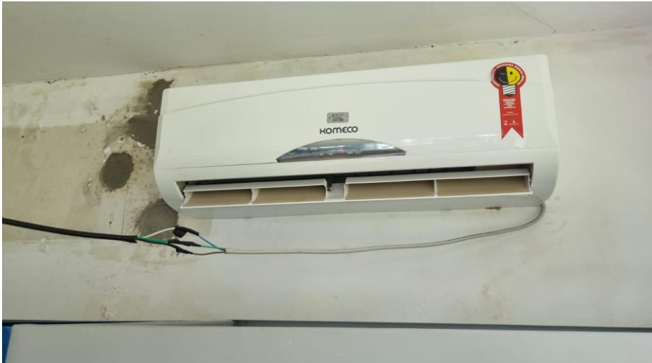
Imagem 2 - Fio original do ar-condicionado cortado e emendado
