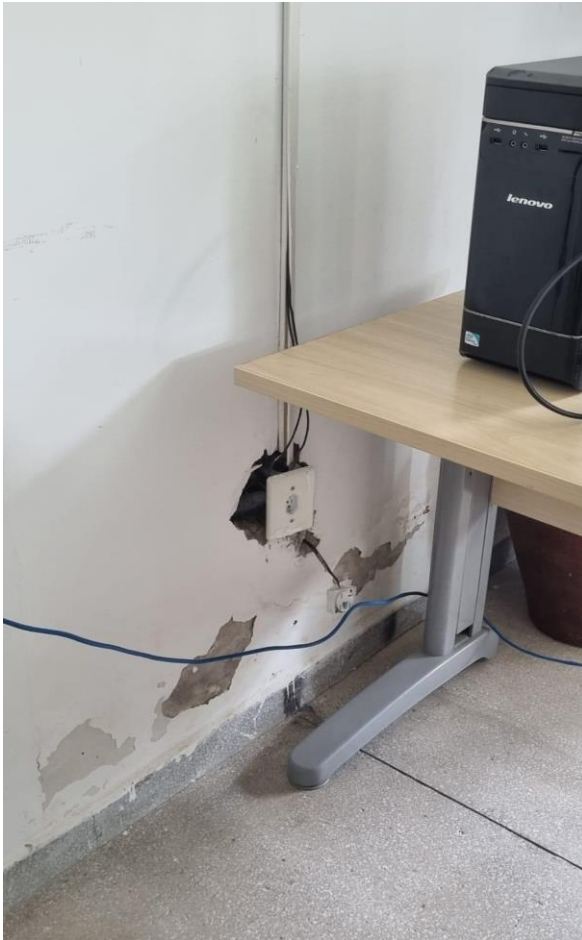
Imagem 4 – Instalações elétricas aparentemente inapropriadas
