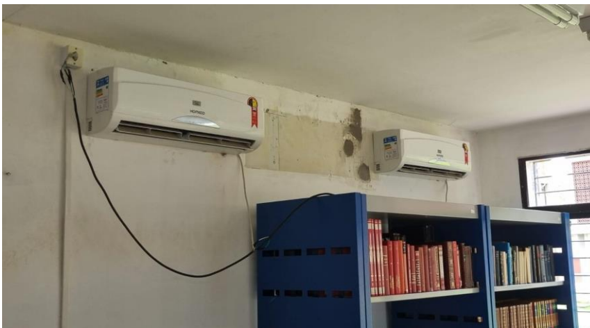
Imagem 1 - Junção de 2 equipamentos em um único condutor
