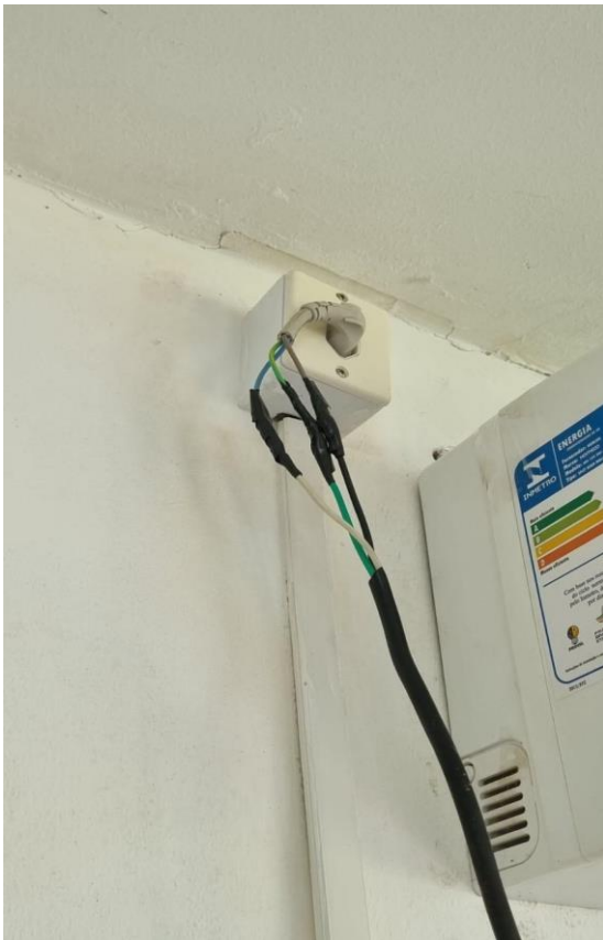
Imagem 3 - Tomada do ar-condicionado cortada da sua fiação original
