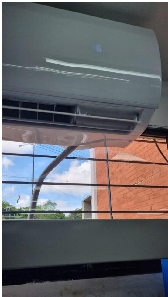
Imagem 5 – Vidro quebrado para passagem de duto do ar-condicionado.
