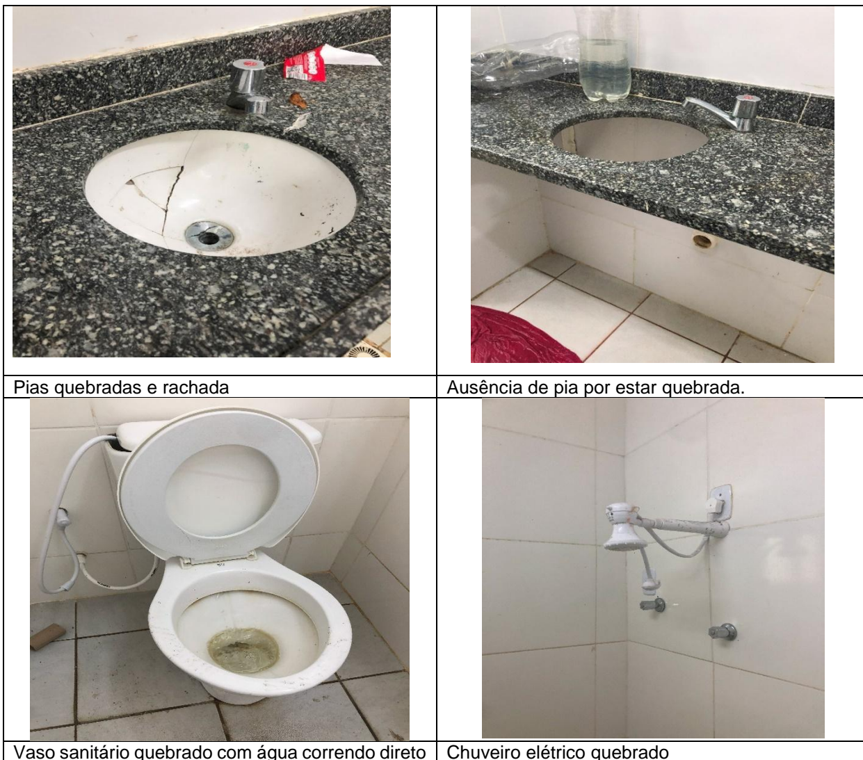
Imagem 18 - Peças e equipamentos quebrados no banheiro coletivo
