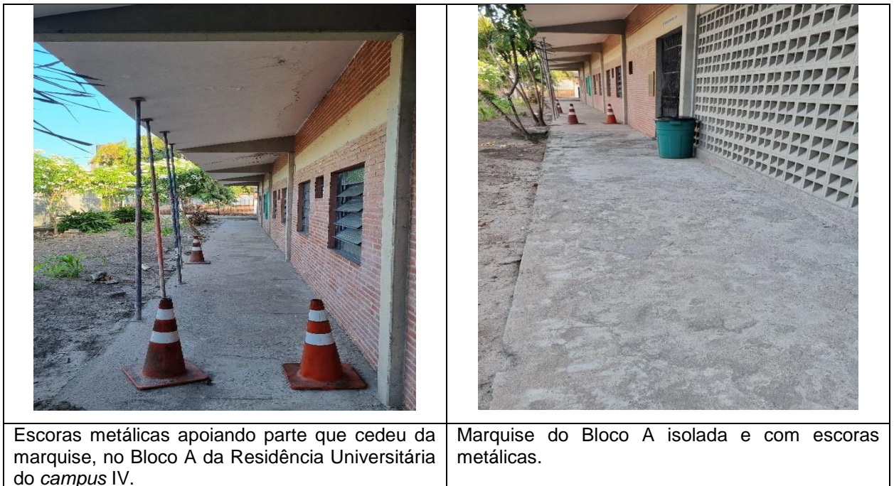
Imagem 20 - Problemas estruturais no Bloco A das Residências Universitárias de Rio Tinto
