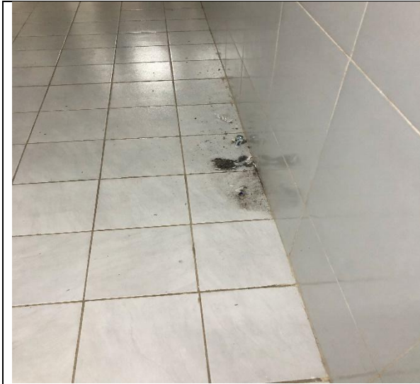
Detalhe de corredor com sujeira no campus II
