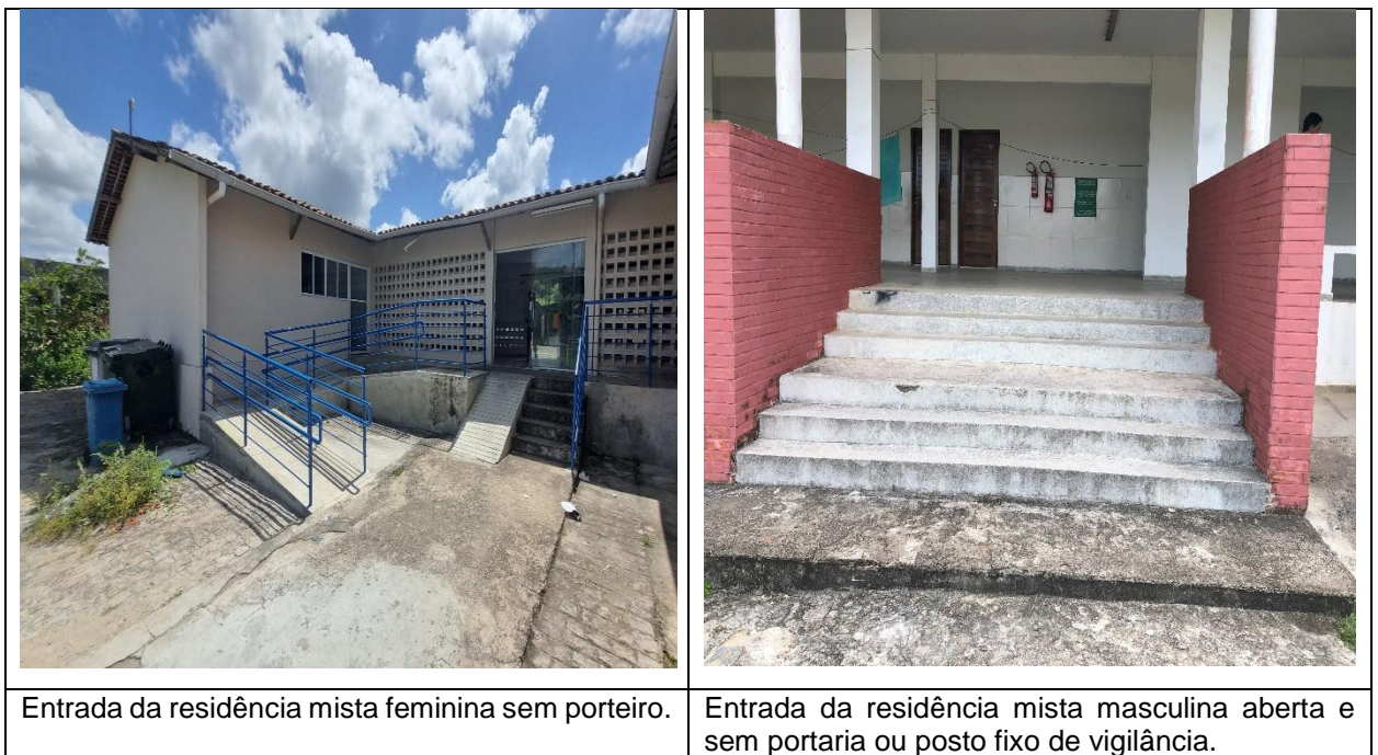
Imagem 03 - Ausência de Portaria na entrada das Residências Mistas
