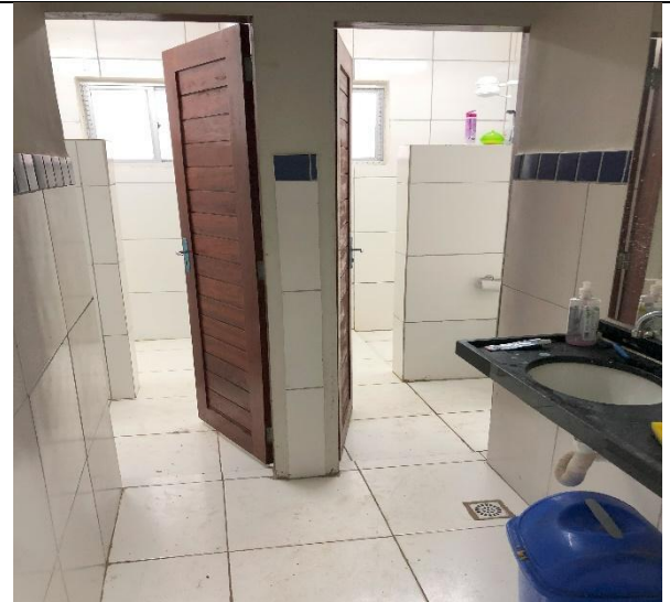
Banheiro coletivo no campus II sem limpeza
