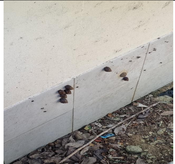
Presença de caramujos no bloco F no campus II
