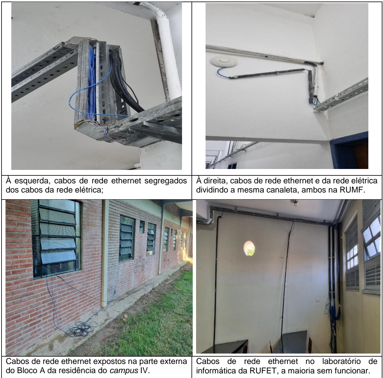
Imagem 09 - Cabos de rede (ethernet) em contato com a rede elétrica
