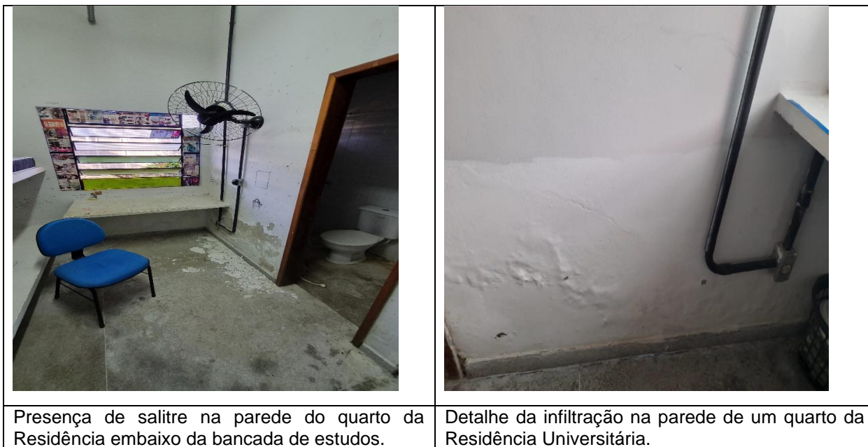
Imagem 23 - Presença de salitre nas paredes dos dormitórios
