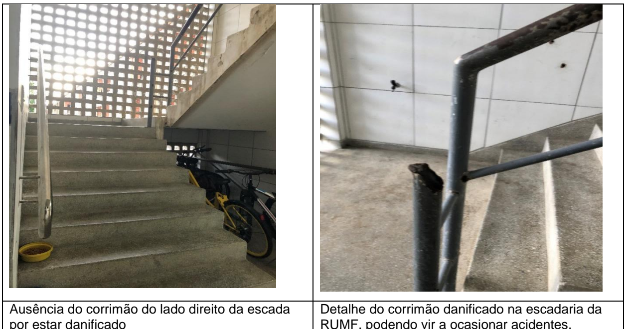
Imagem 13 - Corrimão das escadas danificados
