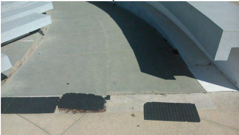
FIGURA 8 – Foto de sinalização tátil deteriorada
