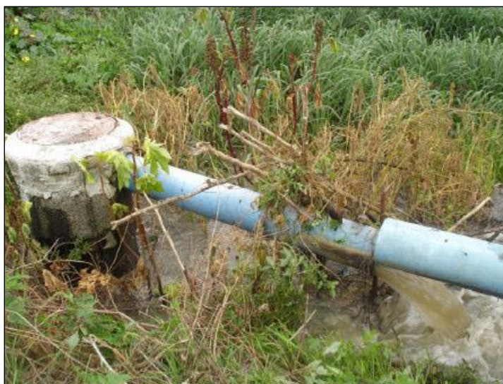
Figura 41 – Tubulação extravasora da ETE de Mangabeira, lançando efluentes in natura no rio Cabelo. Fonte: Farias (2006, p. 67).
