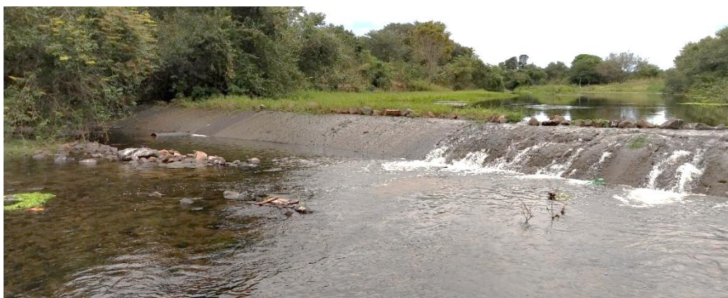
Figura 20. Barragem de nível do ponto de captação de águas do município de Catolé do Rocha
