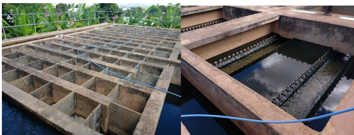
Figura 21. Estação de Tratamento de Águas de Catolé do Rocha: a) Câmaras dos flocculadores; b) Câmaras de decantação
