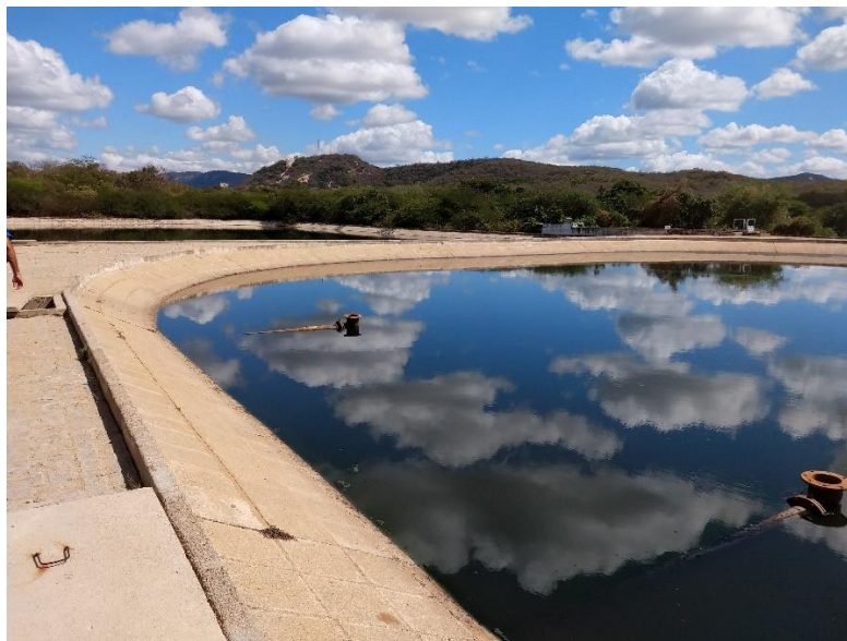
Figura 24. Sistema de lagoas facultativas da Estação de Tratamento de Esgoto de Catolé do Rocha
