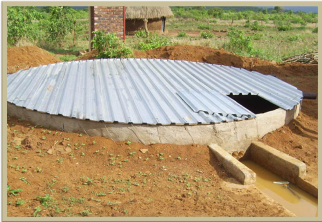
PHOTO 1 - SYSTEME DE CAPTAGE ET STOCKAGE EN AFRIQUE DU SUD (RESERVOIR DE 30M 3 ) (LUONG, 2002)
