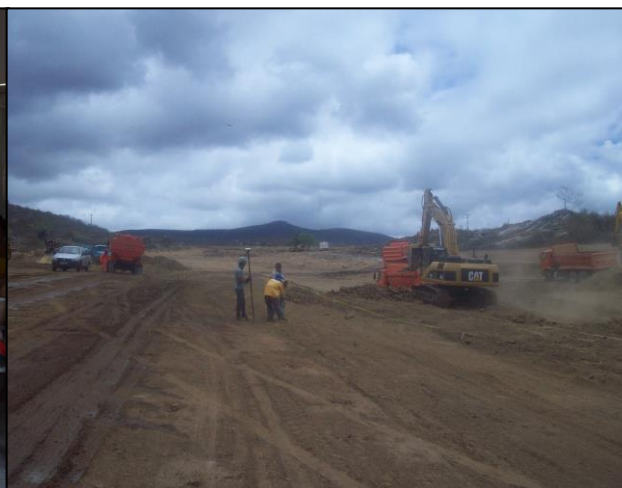
Figura 16 – Execução da obra do Canal da Vertente Litorânea – comunidade rural de Melancia (Franklyn 24/10/2012)
