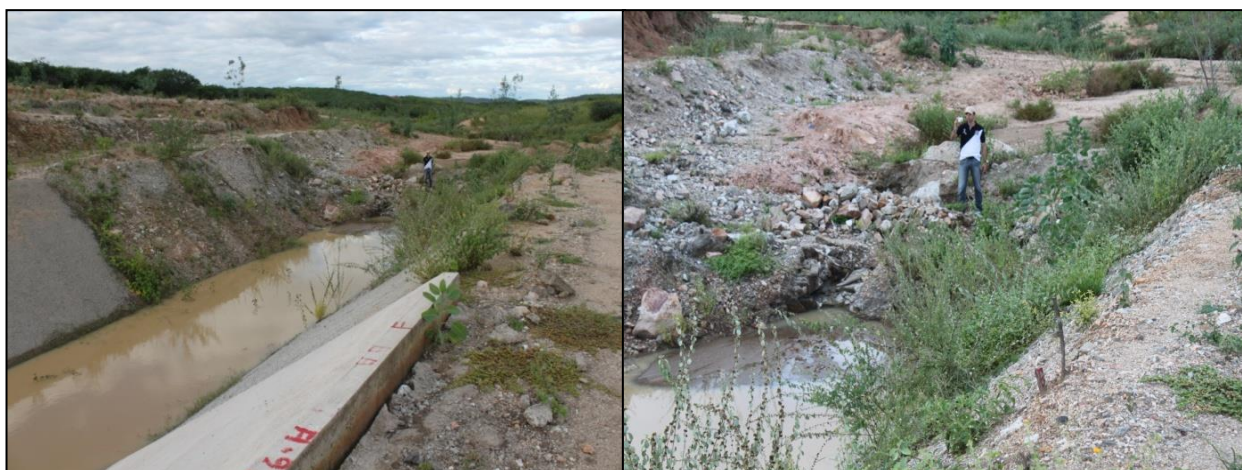
Figura 9 – Área onde parte do canal é interrompido para construção do último reservatório do Eixo Leste, no município de Sertânia (PE) a 10 km do território paraibano (Pedro Vianna 23/05/2011)
