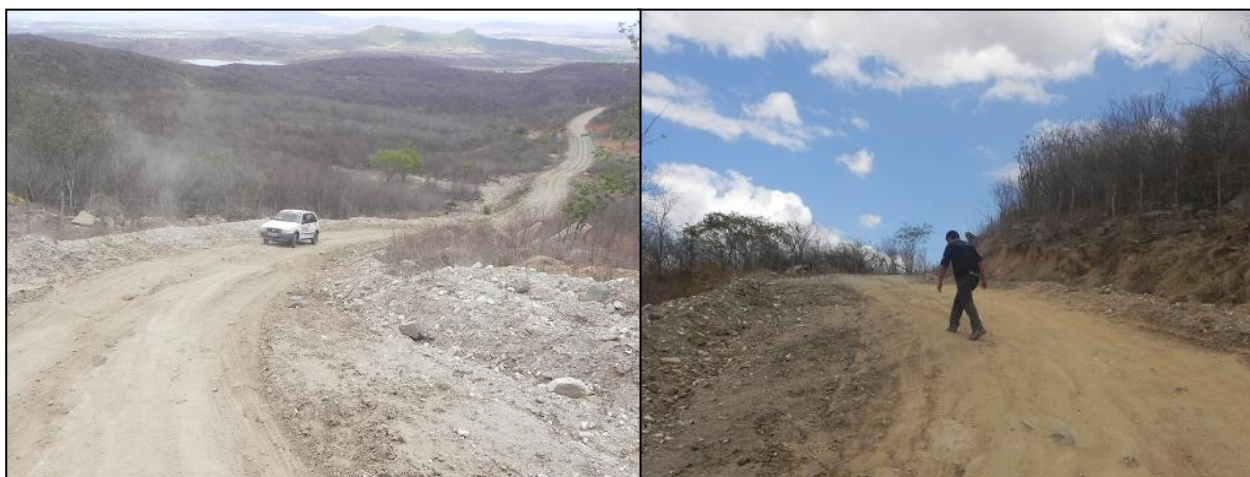
Figura 88 – Estrada de acesso à comunidade do Costa (Franklyn 14/03/2013)
