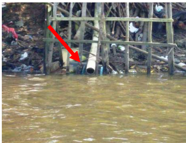
Figura 8 – Despejo direto de esgotos
